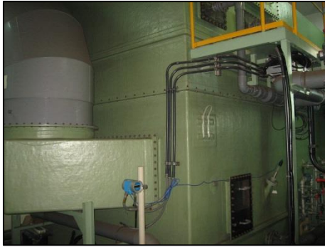
酸アルカリ洗浄塔
