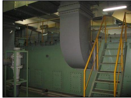
活性炭脱臭塔
