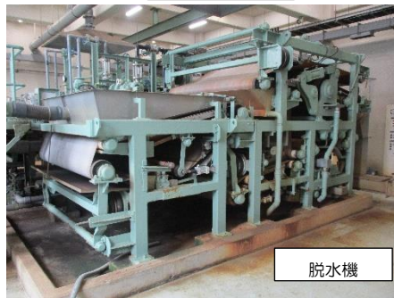
汚泥処理設備
