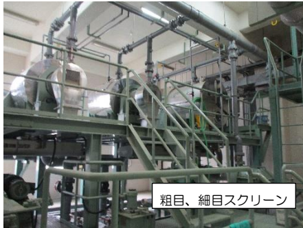
受入貯留設備
