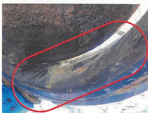
シーリングゴム (腐食状況)
