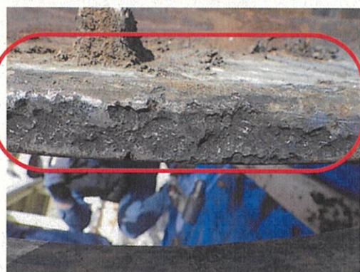
弁体 (腐食状況)
