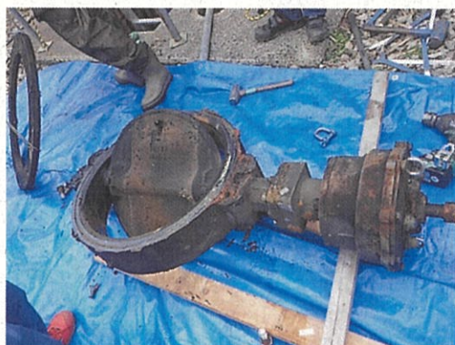
流入ゲート弁本体
