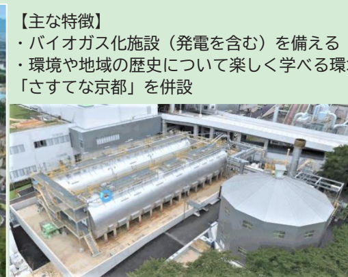
メタン発酵プラント
